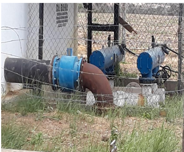
Foto 4.6 – Sistema de Filtros Coletivos (inoperantes)
