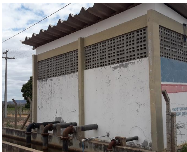
Foto 4.7 – EB de Pressurização 02
