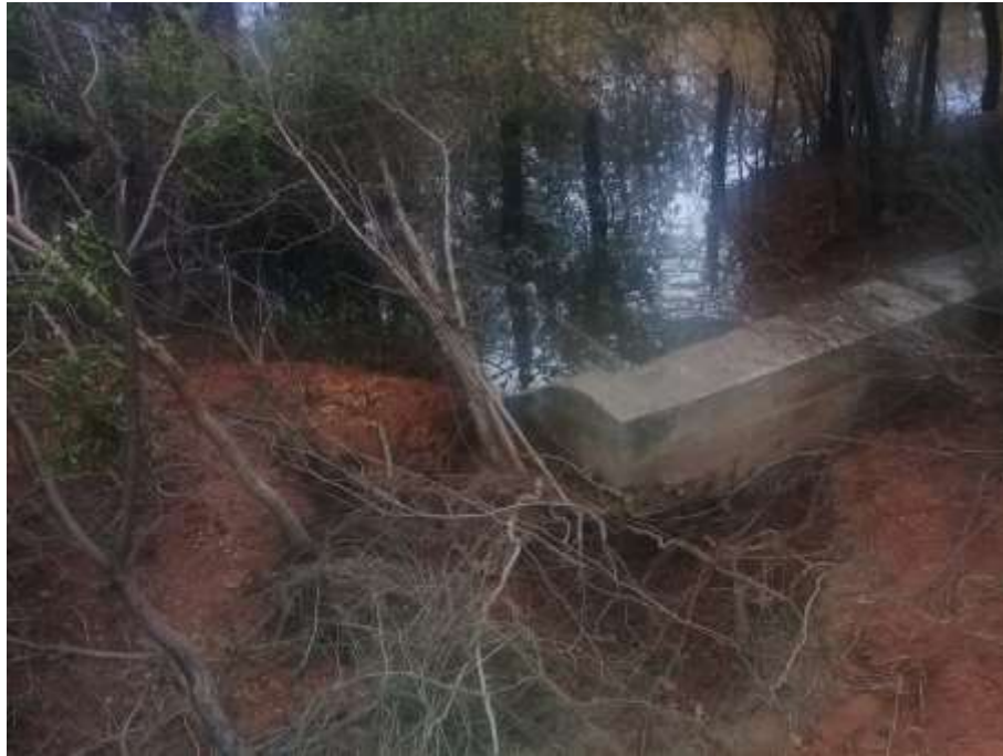
Foto 17: Erosão no talude montante do Dique do Rio Mosquito – Ponto DIQUE36PT Coordenadas UTM 685.384 m E; 8.272.137 m S.
