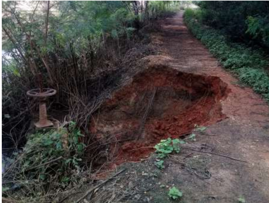
Foto 15: Erosão no Dique do Rio Mosquito – Ponto DIQUE24 Coordenadas UTM 685.155 m E; 8.271.546 m S.
