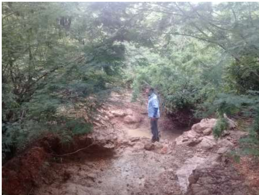
Foto 18: Ruptura do Dique do Rio Mosquito – Ponto DIQUE38 Coordenadas UTM 685.361 m E; 8.272.181 m S.
