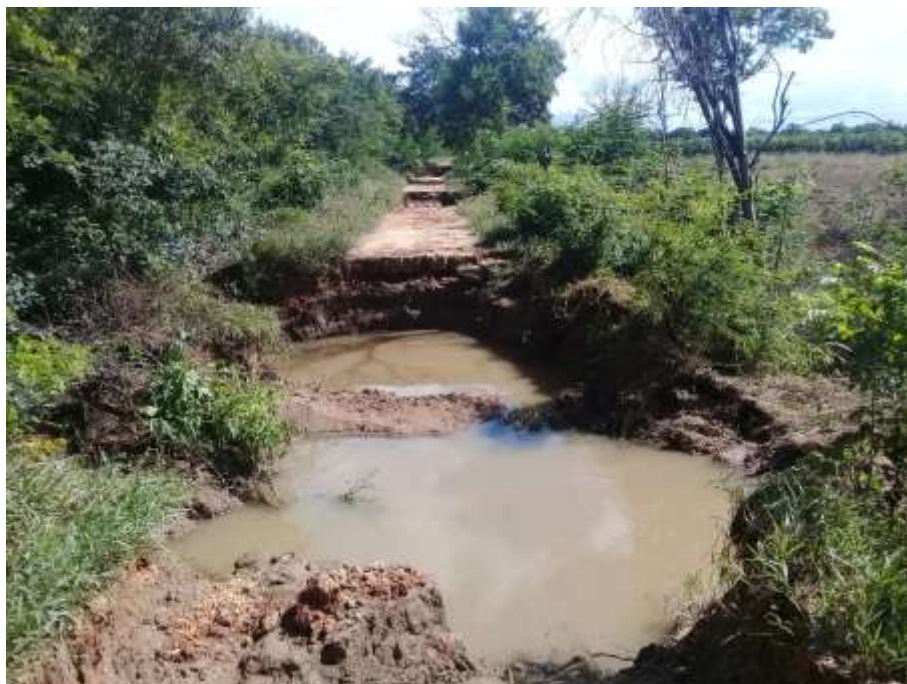
Foto 04: Ruptura do Dique do Rio Mosquito – Ponto DIQUE5 Coordenadas UTM 685.011 m E; 8.269.112 m S.
