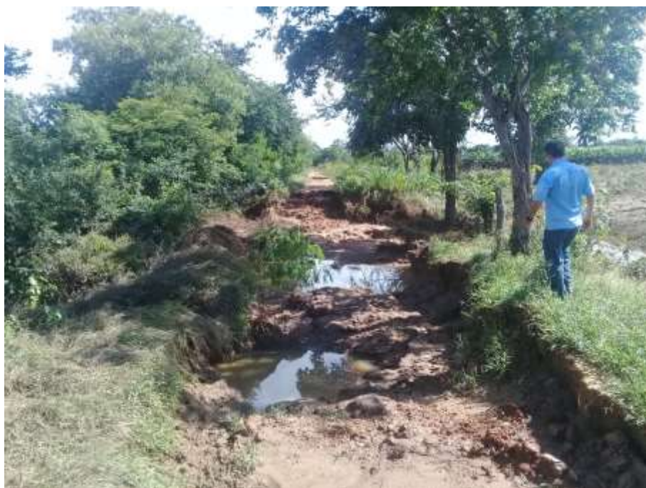
Foto 06: Ruptura do Dique do Rio Mosquito – Ponto DIQUE7 Coordenadas UTM 685.019 m E; 8.268.994 m S.
