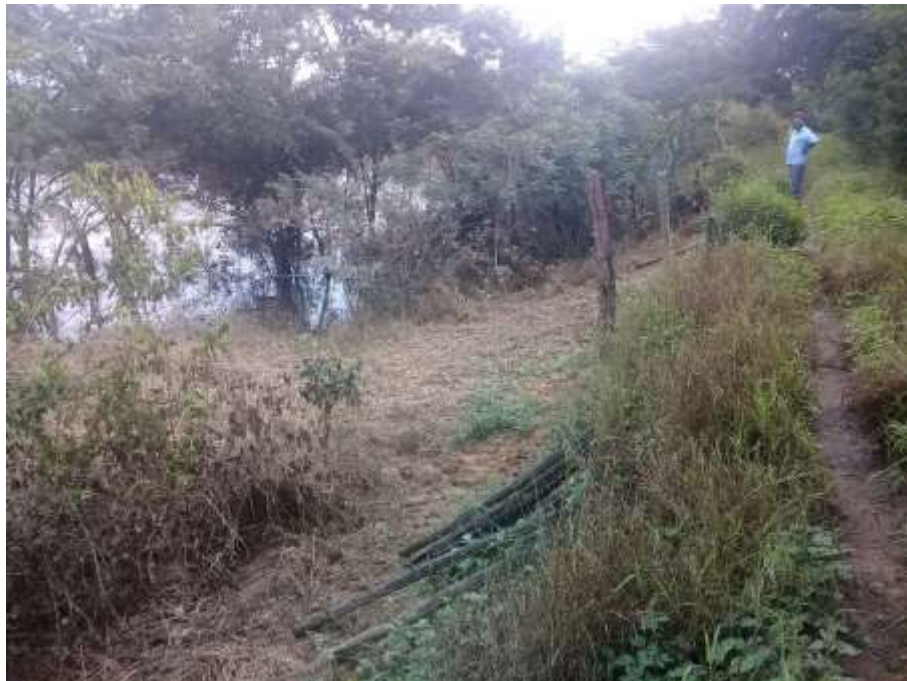
Foto 16: Erosão no talude jusante do Dique do Rio Mosquito – Ponto DIQUE27 Coordenadas UTM 685.340 m E; 8.271.685 m S.
