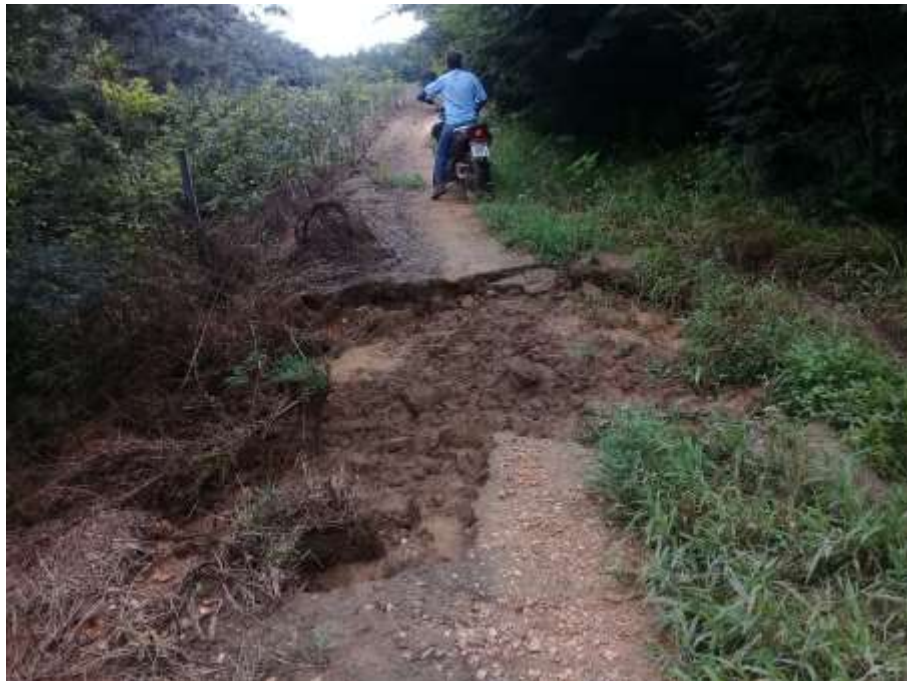
Foto 14: Erosão no Dique do Rio Mosquito – Ponto DIQUE21P Coordenadas UTM 685.486 m E; 8.270.507 m S.
