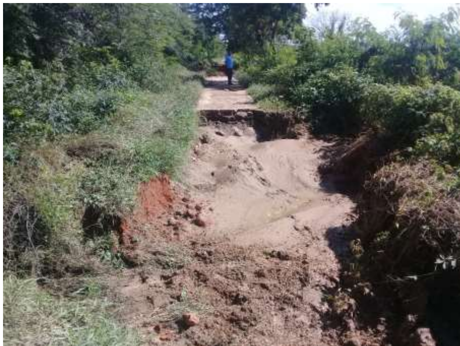
Foto 05: Ruptura do Dique do Rio Mosquito – Ponto DIQUE6 Coordenadas UTM 685.014 m E; 8.269.053 m S.
