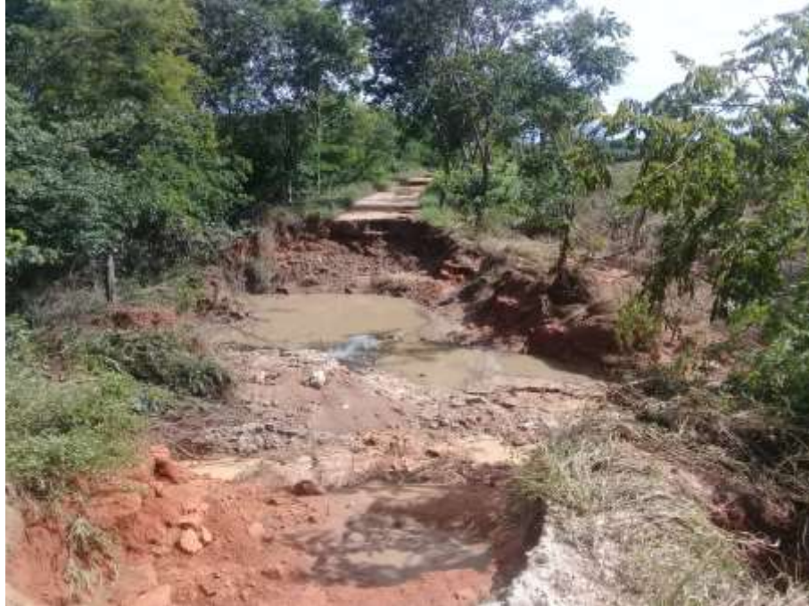
Foto 03: Ruptura do Dique do Rio Mosquito – Ponto DIQUE4 Coordenadas UTM 685.003 m E; 8.269.152 m S.
