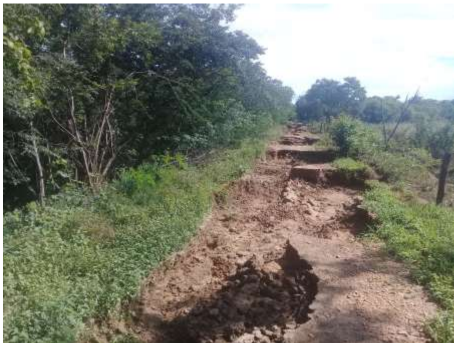
Foto 09: Erosão no Dique do Rio Mosquito – Ponto DIQUE11 Coordenadas UTM 685.023 m E; 8.268.855 m S.
