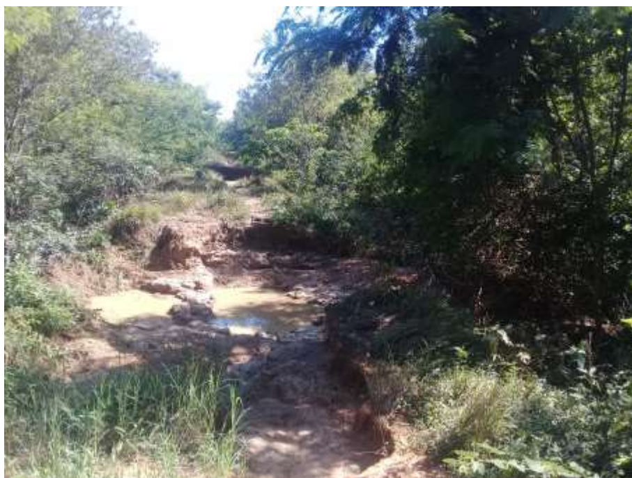
Foto 10: Ruptura do Dique do Rio Mosquito – Ponto DIQUE12 Coordenadas UTM 685.028 m E; 8.268.692 m S.
