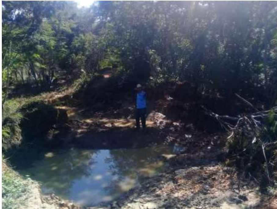
Foto 11: Ruptura do Dique do Rio Mosquito – Ponto DIQUE15 Coordenadas UTM 685.007 m E; 8.268.542 m S.
