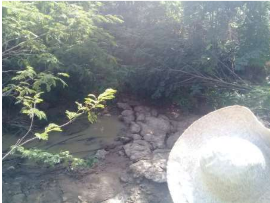
Foto 13: Ruptura do Dique do Rio Mosquito – Ponto DIQUE17 Coordenadas UTM 684.910 m E; 8.268.436 m S.
