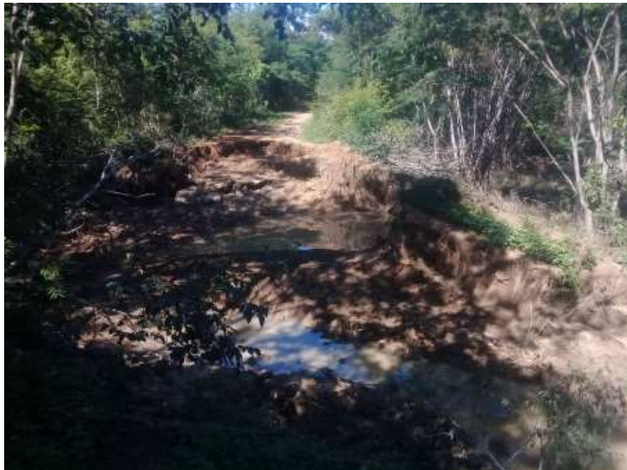
Foto 12: Ruptura do Dique do Rio Mosquito – Ponto DIQUE16 Coordenadas UTM 684.944 m E; 8.268.473 m S.
