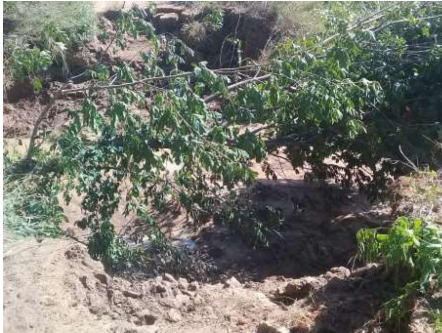
Foto 07: Ruptura do Dique do Rio Mosquito – Ponto DIQUE8 Coordenadas UTM 685.020 m E; 8.268.976 m S.
