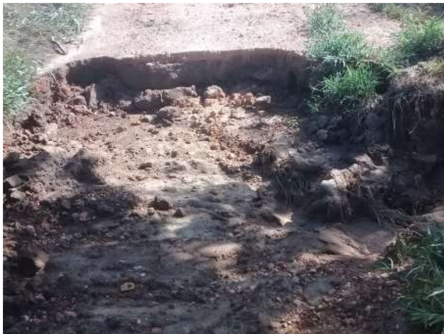
Foto 08: Erosão no Dique do Rio Mosquito – Ponto DIQUE10P Coordenadas UTM 685.024 m E; 8.268.884 m S.
